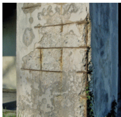
Phénomène de corrosion d'un pilier en béton
