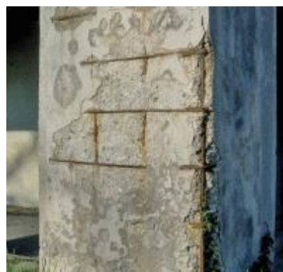
Phénomène de corrosion d'un pilier en béton
