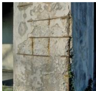
Phénomène de corrosion d'un pilier en béton
